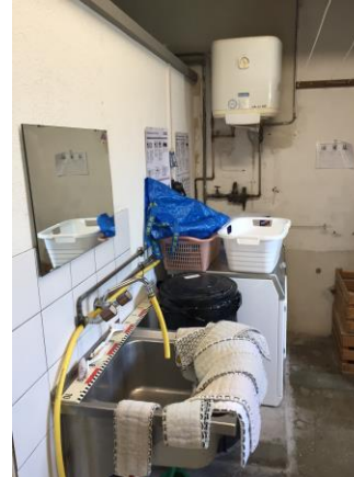
Elektrischer Wassererwärmer für Waschküche
