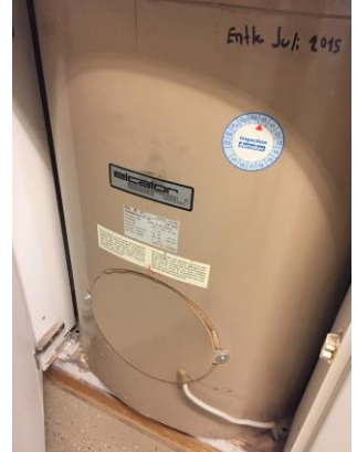
Elektrischer Wassererwärmer für Küche
