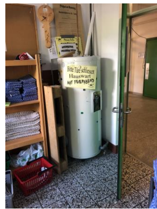
Elektrischer Wassererwärmer für Abwart und WC Anlagen
