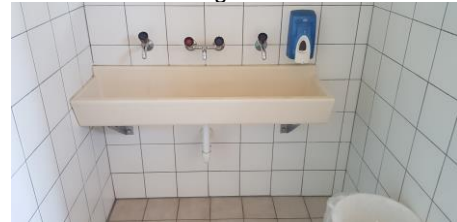
Waschrinne in WC Anlagen mit dreimal Kaltwasser und einmal Warmwasser
